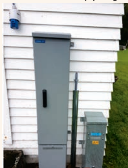
Nytt strømskap med trefaset kontakt til gravtineren.
